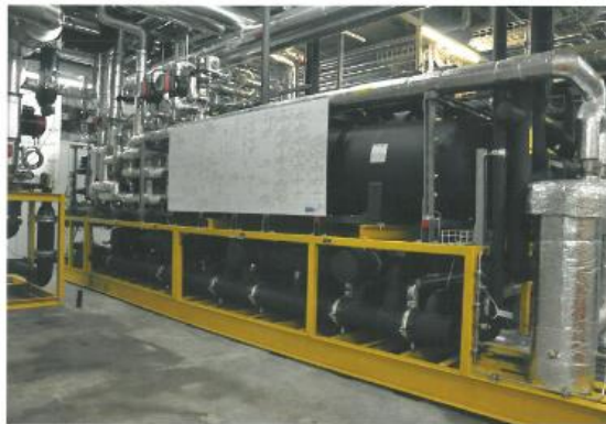
Diese neue CO 2 -Verbundanlage wurde im Schweizer Fleischverarbeitungsbetrieb Bigler installiert.
