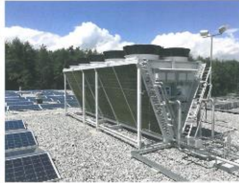
Der CO 2 -Gaskühler auf dem Dach besitzt eine Leistung von 800 Kilowatt.
